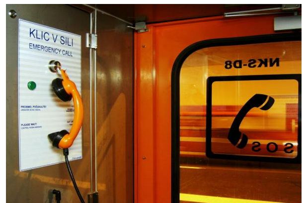
In-tunnel SOS niche, Šentvid, SLO
